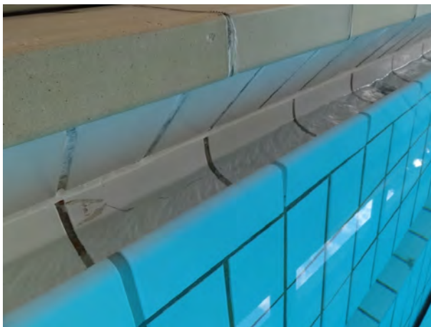
Beckenkopf mit Überlaufrinne: Gerissener Rinnenstein und Kittfuge
