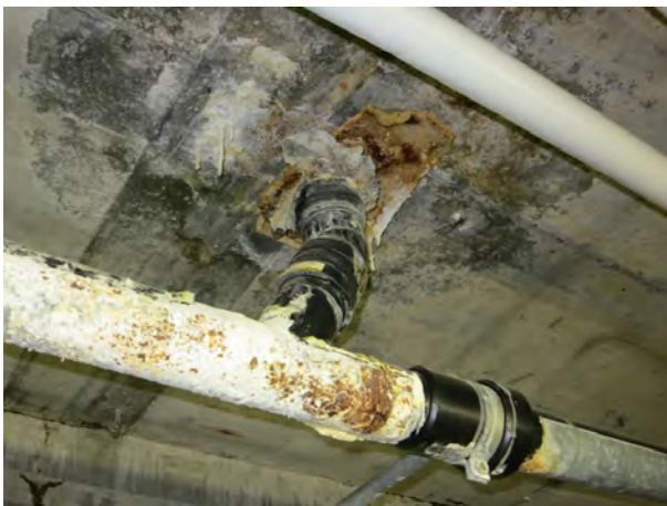
undichter Ablauf vom Beckenumgang
