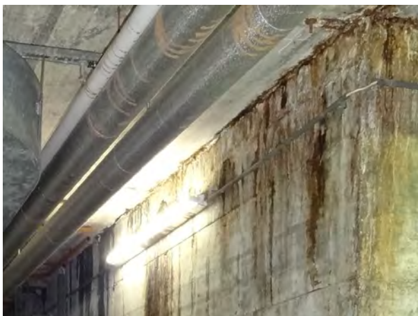
Spuren von wiederholtem Wasseraustritt im Untergeschoss
