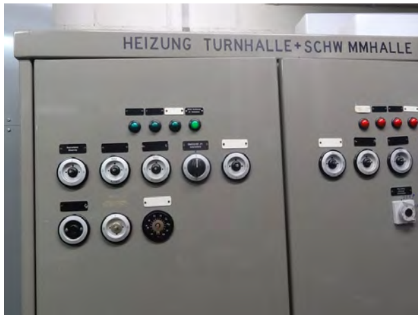
Schaltschrank Umformer Schwimmbadwasser
