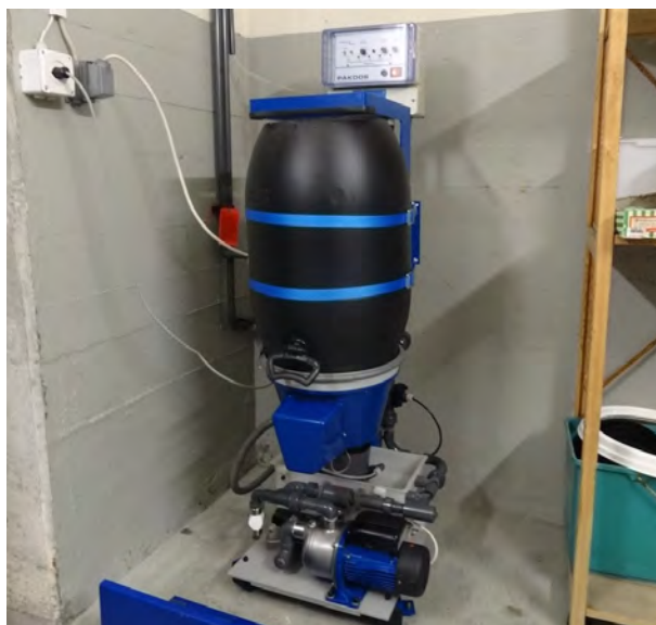
Dosieranlage für Pulver-Aktivkohle
