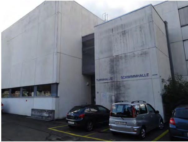
Verfärbungen an der Betonfassade durch feuchte Abluft aus der Lüftungsanlage
