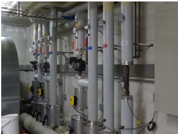
Heizungsverteiler im 1. UG
