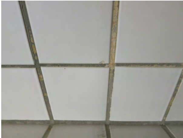
ausgeschwemmte Plattenfugen im Becken
