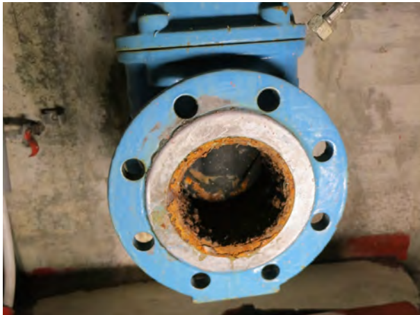
korrodierte Leitungsanschlüsse bei den Filterpumpen
