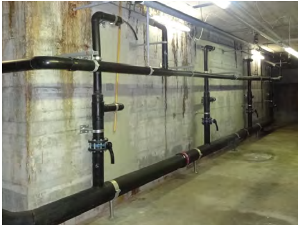
Stirnseite des Beckens mit Reinwasser- Leitung PE (unten) zu den Einlaufdüsen und Rinnenrücklaufleitung PE (oben)
