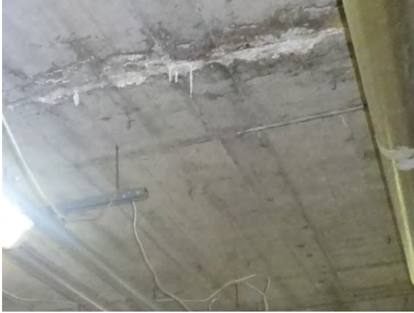
Spuren von wiederholtem Wasseraustritt im Untergeschoss
