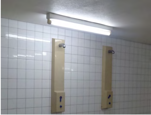
aufputz montierte Deckenbeleuchtung
