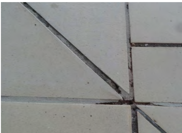
ausgeschwemmte Plattenfugen in Beckenumgängen
