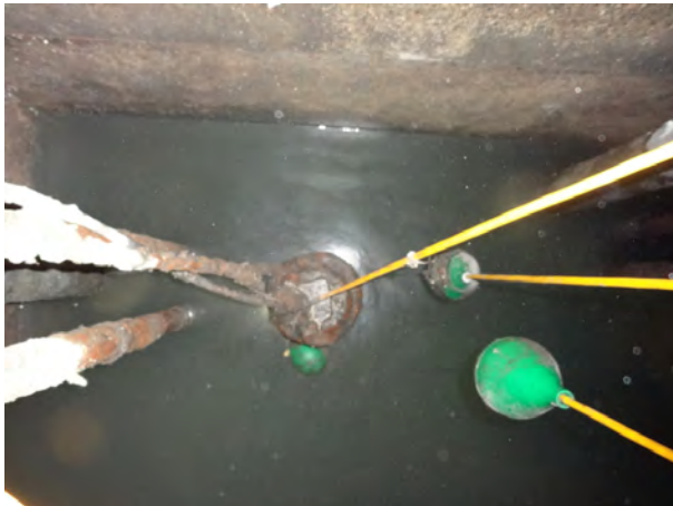
Pumpenschacht mit Abwasserpumpen
