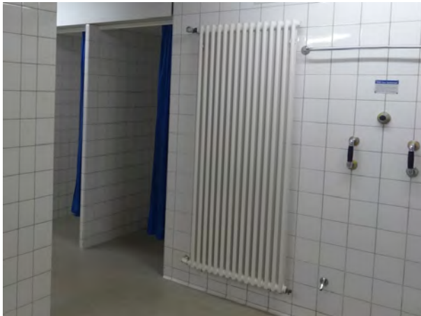
Röhrenradiatoren an der Wand
