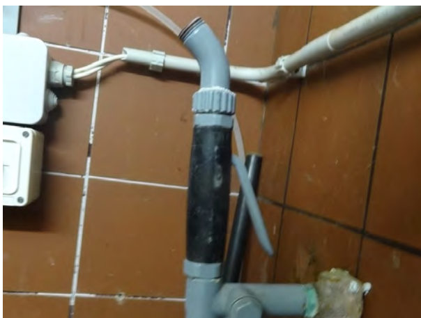
der bestehende Wasseranschluss kann die Funktion als Augendusche kaum erfüllen
