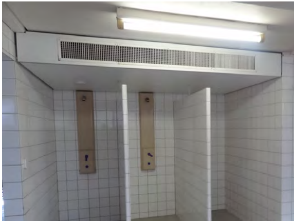
abgehängte Decke mit Lüftungsgitter
