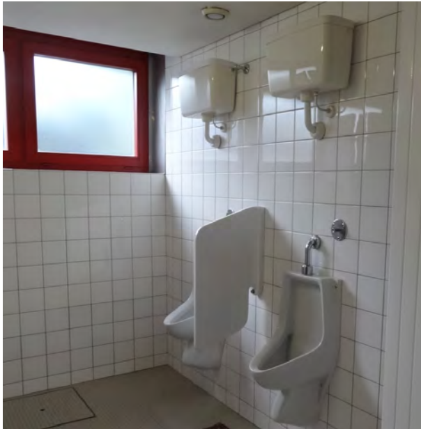
Sanitäre Apparate im ursprünglichen Zustand
