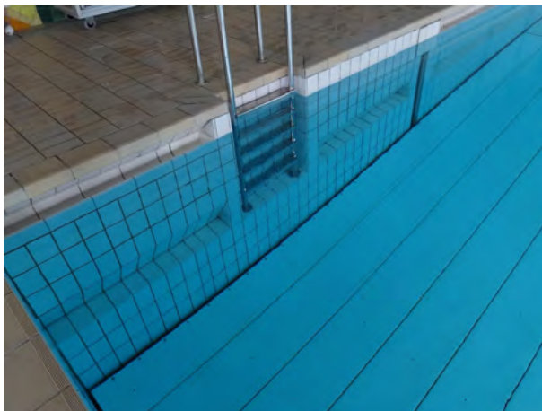
Beckenkörper mit Überlaufrinne, Stehstufe, Nischenleiter und Hubboden
