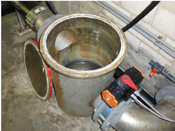
Vorfilterbehälter mit leichter Korrosion
