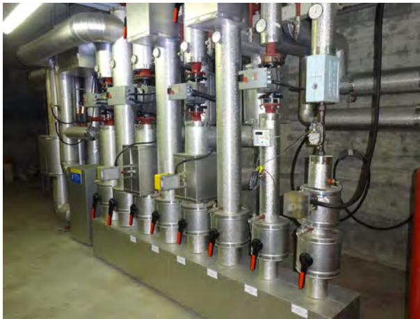
Fernheizungsverteiler im 2.UG
