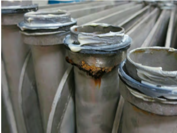
Filterelemente mit Korrosion
