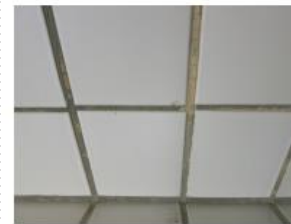
ausgeschwemmte Plattenfugen im Becken
