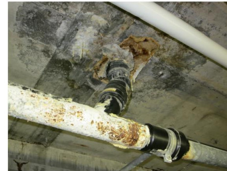
undichter Ablauf vom Beckenumgang
