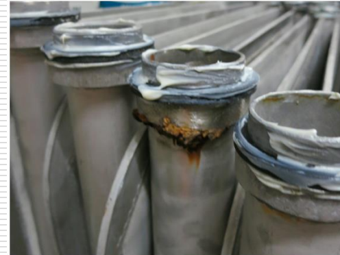
Filterelemente mit Korrosion
