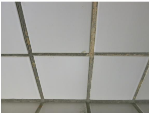
ausgeschwemmte Plattenfugen im Becken
