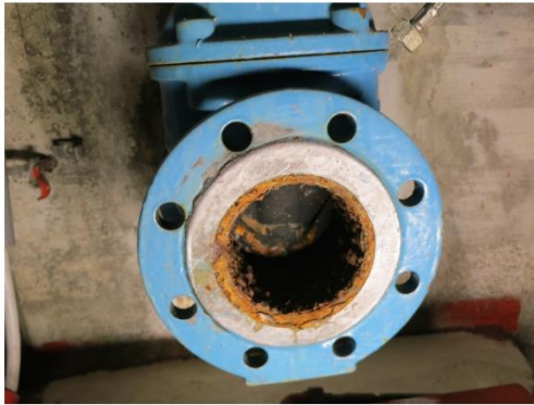
korrodierte Leitungsanschlüsse bei den Filterpumpen
