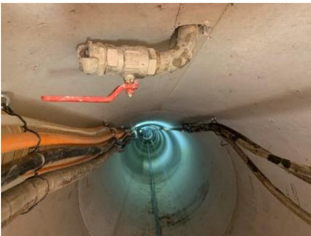
Injektionsstutzen im Scheitel eines Vortriebsrohrs.
