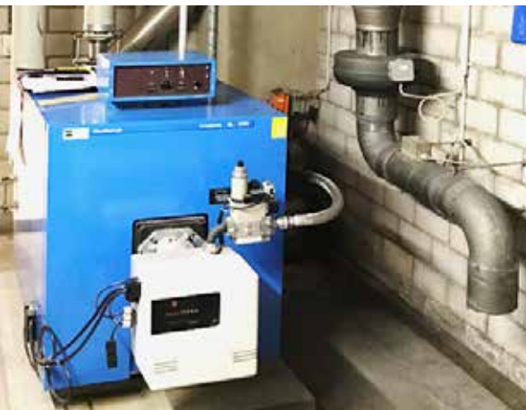
Ersatz bestehender fossiler Heizungen
