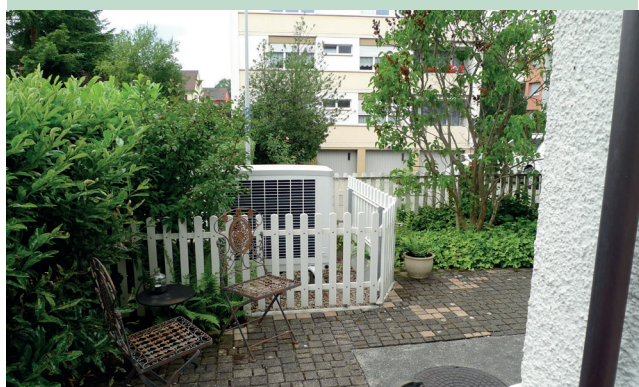
Wärmepumpe im Garten integriert - Bild: W. Thommen
