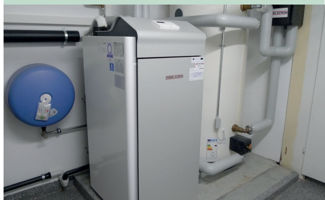
Neue Wärmespeicheranlage im Keller - Bild: W. Thommen
