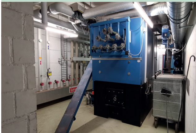
Wärmeverbund Bubendorf: Holzheizkessel - Bild: R. Müller, Gemeinde Bubendorf
