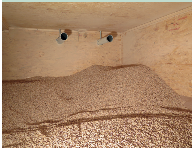
Pelletlager im Keller - Bild: P. und M. Siegrist
