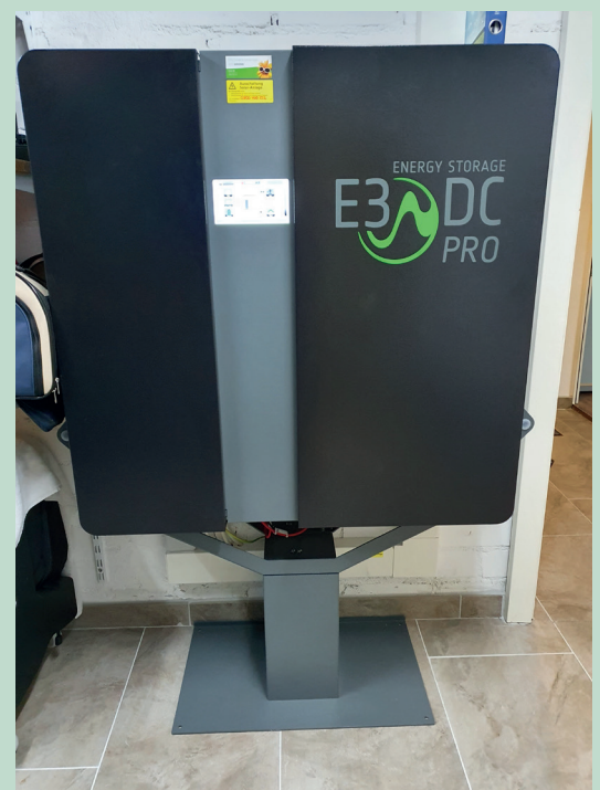
Batterie für den PV-Strom - Bild: S. und T. Routil
