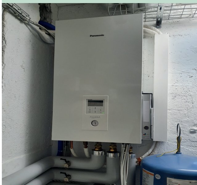
Wärmespeicheranlage der neuen Luft-Wasser-Wärmepumpe - Bild: S. und T. Routil
